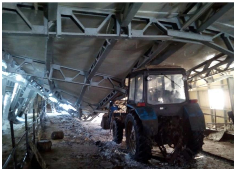
Рис. 4. Обрушенные конструкции коровника в селе Жархан 3 Fig. 4. Collapsed structures of a cowshed in the village of Zharkhan
