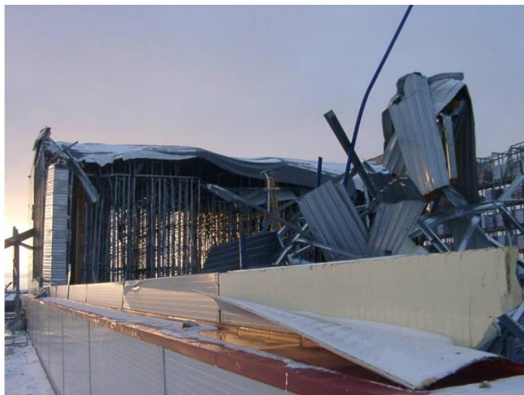
Рис. 1. Обрушенные конструкции склада [13]
