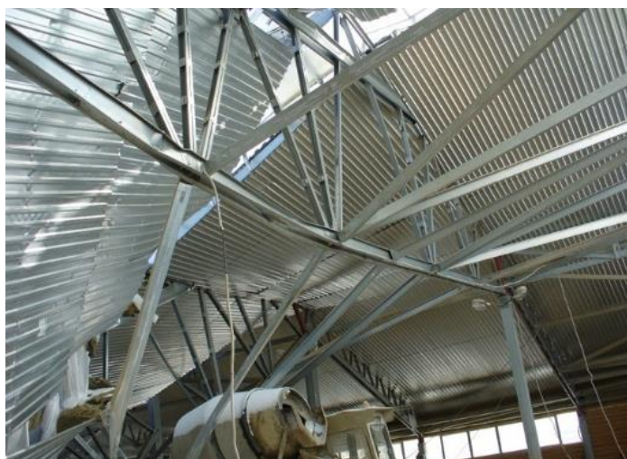
Рис. 2. Обрушенные конструкции коровника в Смоленской обл. 1 Fig. 2. Collapsed structures of a cowshed in the Smolensk region
