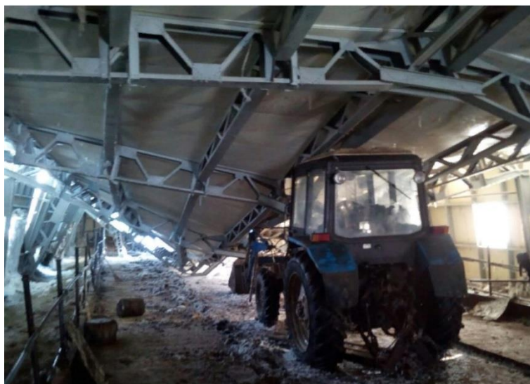
Рис. 4. Обрушенные конструкции коровника в селе Жархан 3 Fig. 4. Collapsed structures of a cowshed in the village of Zharkhan
