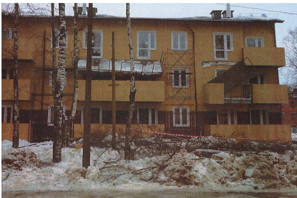
Рис. 6. Обрушение балконов в жилом доме (Великий Новгород, мкрн. Кречевицы) [16] Fig. 6. Collapse of balconies in a residential building (Veliky Novgorod, Krechevitsy microdistrict)
