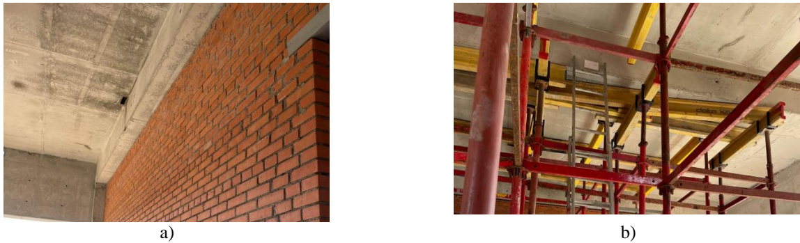
Рис. 3. Фото обследуемых конструкций а – Конструкция 1 ; б – Конструкция 2 Fig. 3. Photo of examined structures: a – Structure 1 ; b – Structure 2
