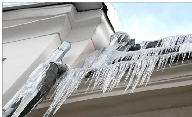
Рис. 2. Наледь и сосульки на водостоках 2 Fig. 2. Ice and icicles on the gutters
