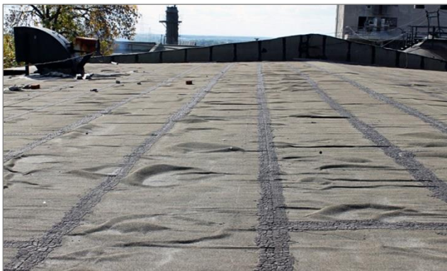
Рис. 3. Неплотное прилегание кровли 3 Fig. 3. Loose adhesion of the roof
