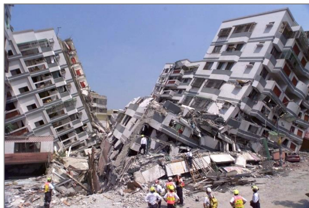
Рис. 3. Разрушение жилых домов, г. Чи-Чи (Тайвань, 1999 г.) 3
