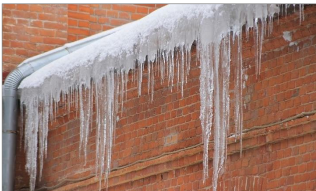
Рис. 1. Наледь и сосульки на скатах крыш 1 Fig. 1. Ice and icicles on roof slopes
