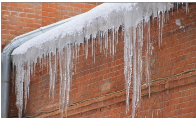
Рис. 1. Наледь и сосульки на скатах крыш 1 Fig. 1. Ice and icicles on roof slopes
